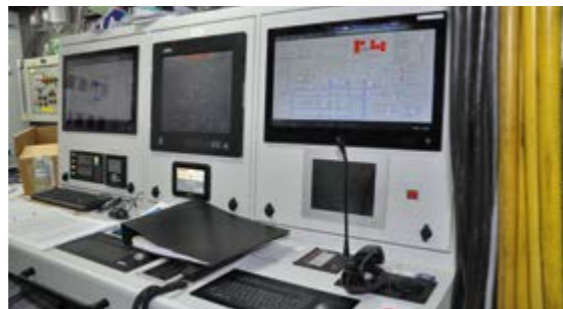
Ständige technische Überwachung im Maschinenraum
