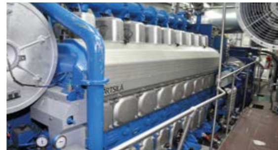
Das Herzstück des Schiffes: Die LNG-Motoren des Herstellers Wärtsilä
